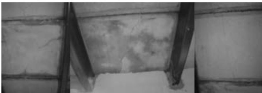
Figura 3.4. Fisuras producidas en el techo Domozed, durante la colocación de la capa de compresión superior.
