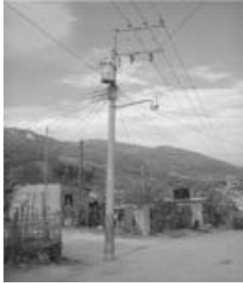
Figura 1.46. Condiciones de calles sin pavimentar, la red de energía eléctrica y alumbrado público.
