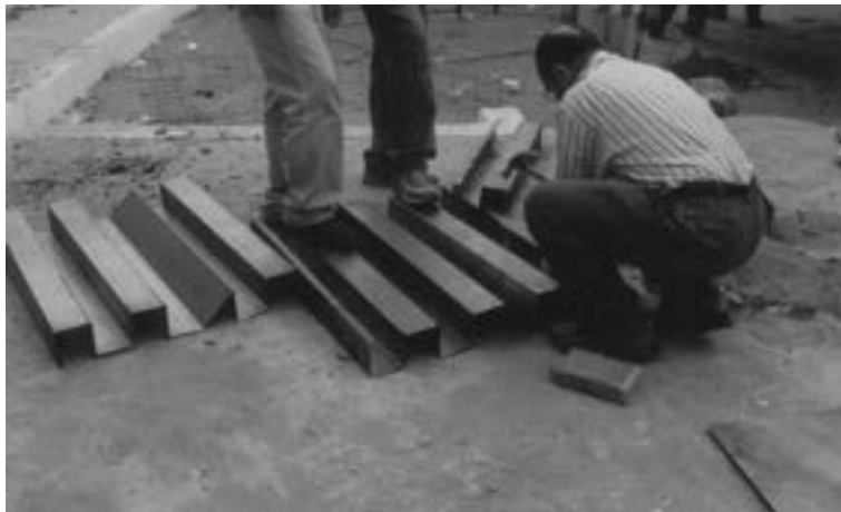
Figura 1.27. Tecnologías presentadas en el Taller de Transferencia de Tecnología de Chiapas. En la imagen se muestra el Proceso de fabricación de pared de SIPROMAT.
