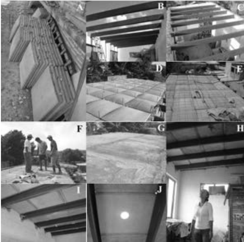
Figura 7.3. Proceso de construcción de techo Domozed, de la foto A hasta la foto J, se observa el proceso sucesivo de fabricación del techo.
