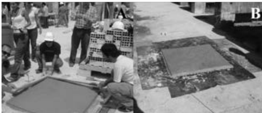
Figura 3.14. Foto A, al terminar de colocar el mortero sobre el petatillo se retira la forma de madera, que se puede utilizar nuevamente. Foto B, la pieza Domotej completada en curación.
