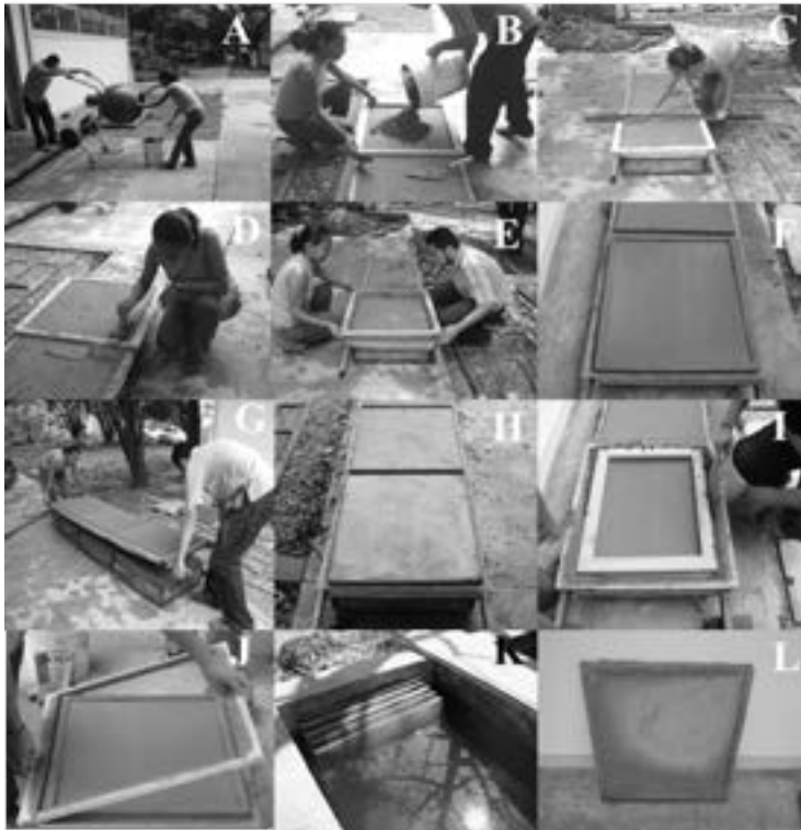
Figura 3.2. Proceso de pre - fabricación de componentes para el techo Domozed, de la foto A hasta la foto F, se observa el proceso de fabricación de componente Domozed.
